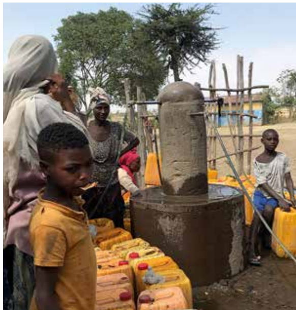
Durch den Bau eines Brunnens hat die Dorfgemeinschaft genügend und vor allem sauberes Wasser.
